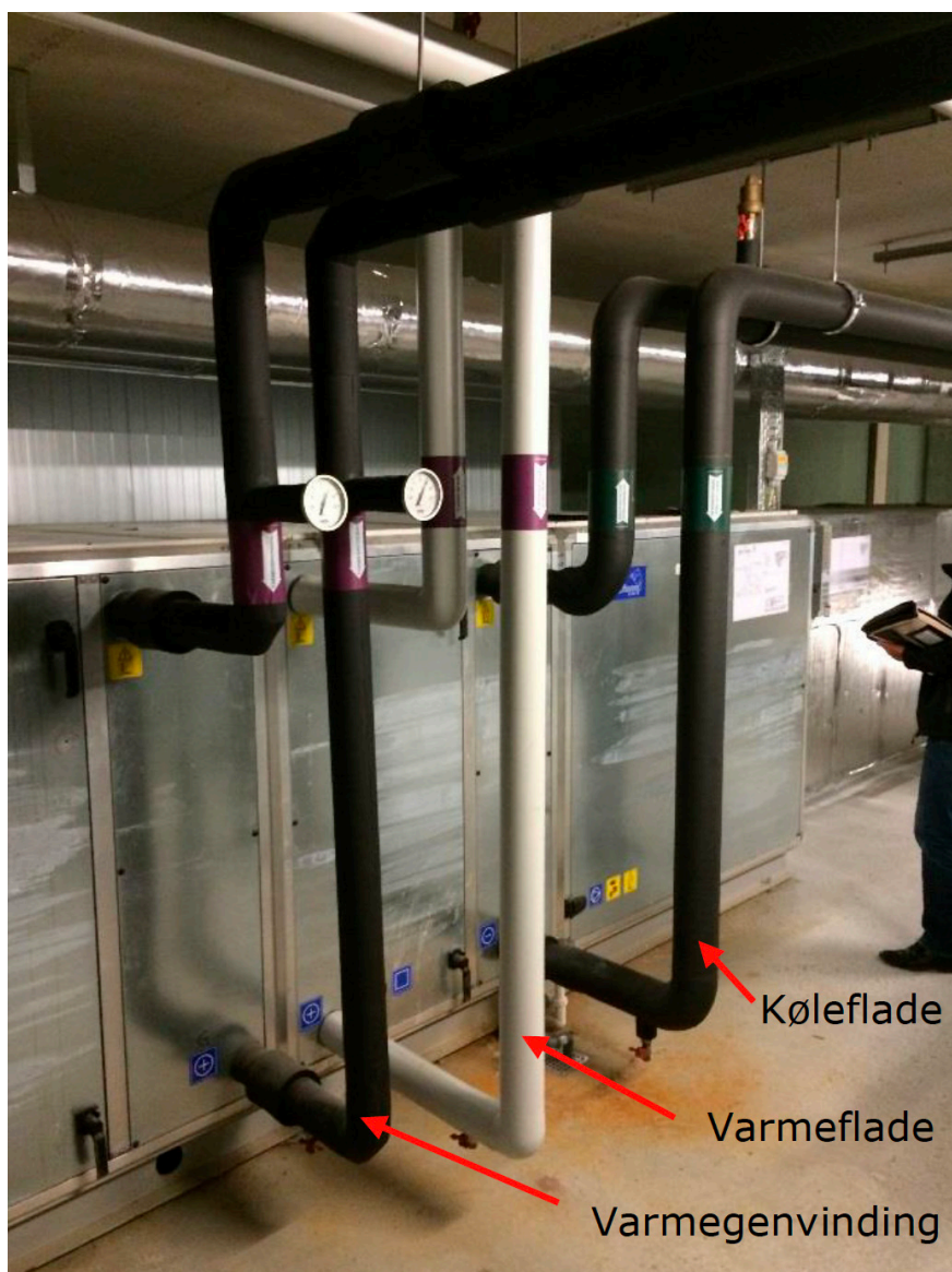
Figur 1. Komfortanlæg med varmegenvinding samt varme- og køleflade
