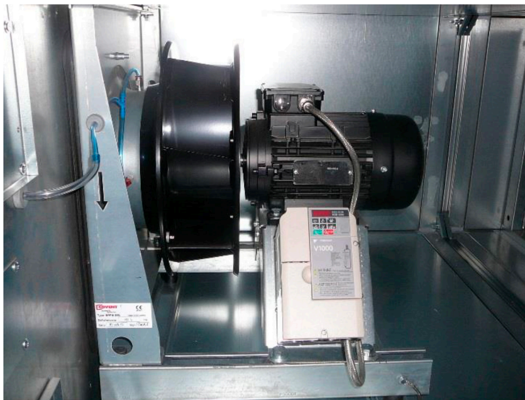
Figur 334. Ventilator med variabel hastighedsregulering
