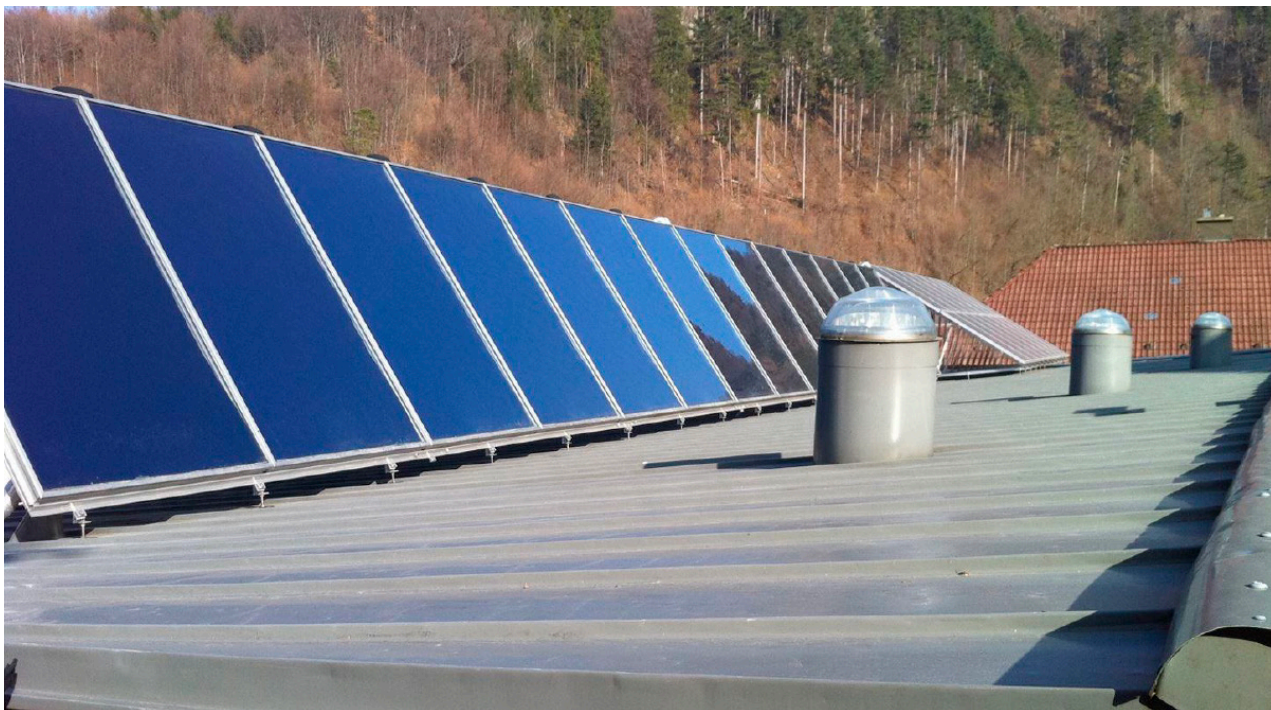
Figur 20 Større solvarmeanlæg til opvarmning af brugsvand på tagflade
